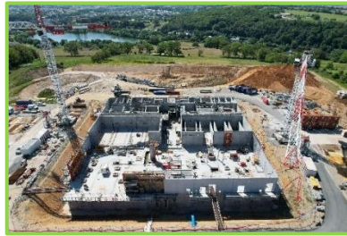
Usine des Eaux – juin 2024
