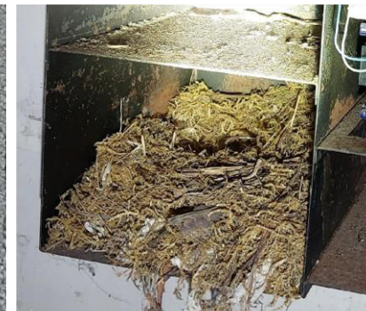
Nids visibles (façade, toiture, dans le bâtiment...)
