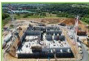
Usine des Eaux – juin 2024
