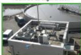
Centrale de cogénération
