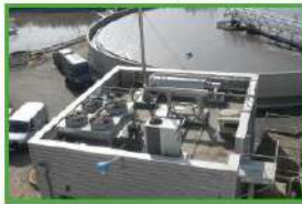
Centrale de cogénération
