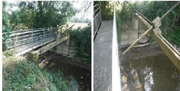
Vue de l'amont rive gauche Vue du mécanisme dégradé Clapet de la Grande Suhardière – La Selle Craonnaise
