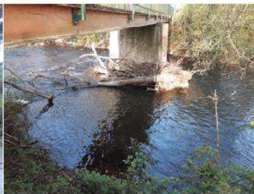
Embâcle à enlever sur la pile de la passerelle de l'aquarelle à St Jean sur Mayenne
