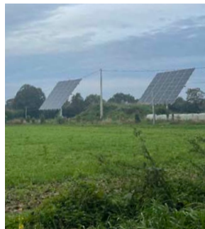
Trackers solaires à Saint-Pierre-la-Cour
