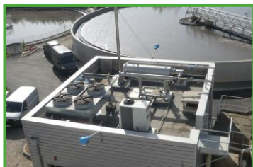
Centrale de cogénération
