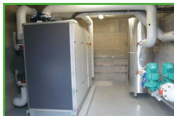
Pompe à chaleur
