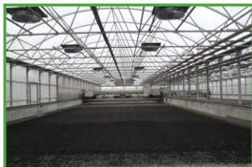
Serres de séchage des boues
