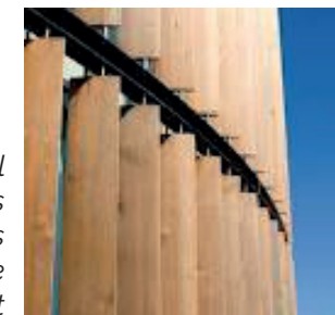
Brise soleil vertical : lutte contre les rayons solaires d'été sur la façade Ouest
