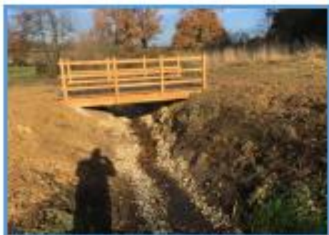
Suppression du busage, restauration du ruisseau et mise en place d'une passerelle
