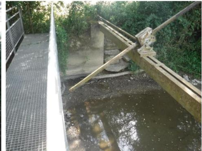
Vue du mécanisme dégradé
