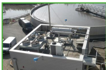
Centrale de cogénération
