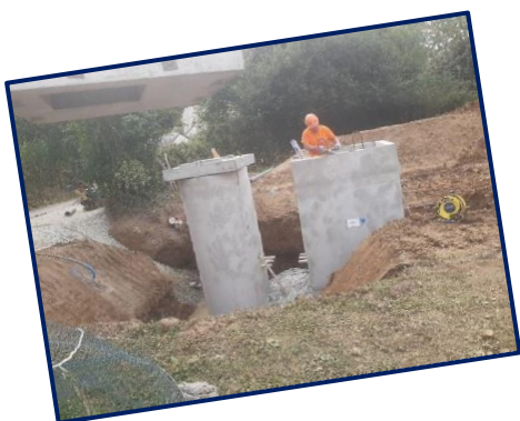
Poste de relèvement au Bois Gamats
