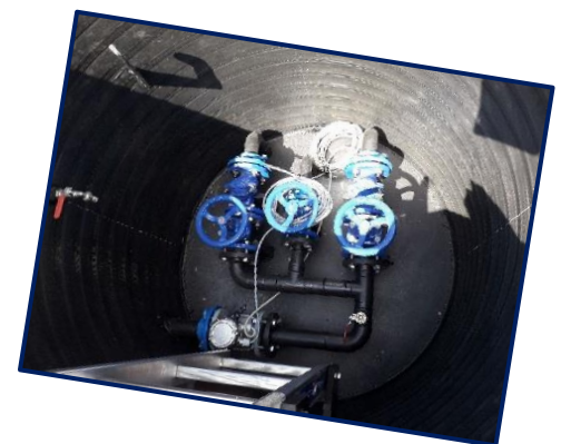
Poste de refoulement de la Boussardière
