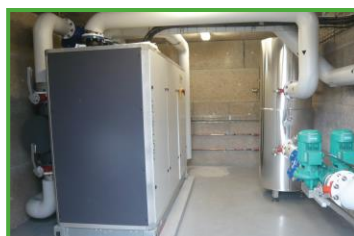
Pompe à chaleur
